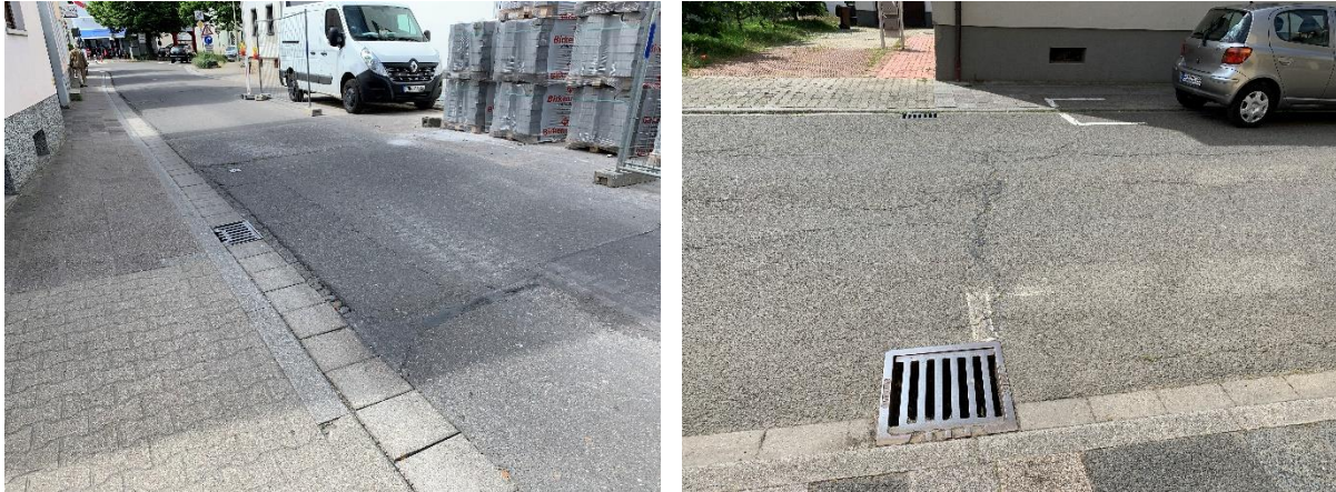
Abb. 1: Straßen und Gehwege mit baulichen und gestalterischen Mängeln, eigene Aufnahme werkplan; Mai 2022
