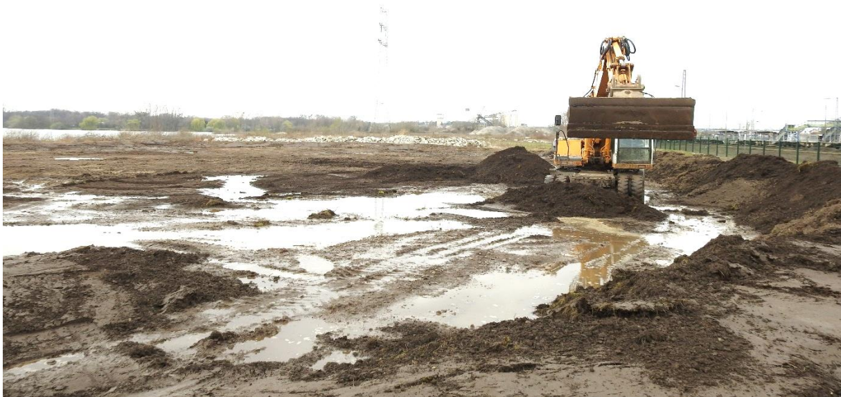
Herstellung flacher Geländemulden im Osten des Geländes, in denen sich anfallendes Regenwasser sammeln kann; Dies wurde als Ausweichhabitat für die Kreuzkröte hergestellt 17.03.2020
