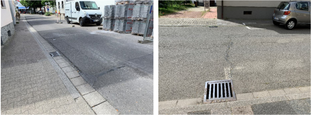
Abb. 4: Straßen und Gehwege mit baulichen und gestalterischen Mängeln, eigene Aufnahme werkplan; Mai 2022
