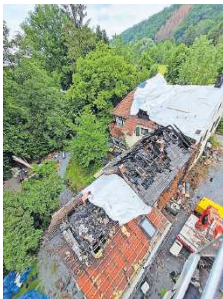
Durch Brand geschädigtes Haus in Lohmar
