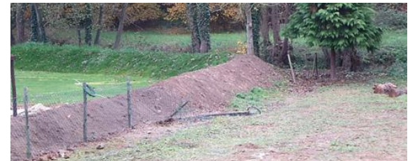
Verwallung / Mauern BCE, www.hochwassermanagement.rlp-umwelt.de
